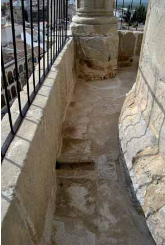
Pavimento original de la torre que ha sido recuperado durante las obras.
