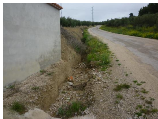
Ilustración 3. Detalle del estado actual de la misma.
