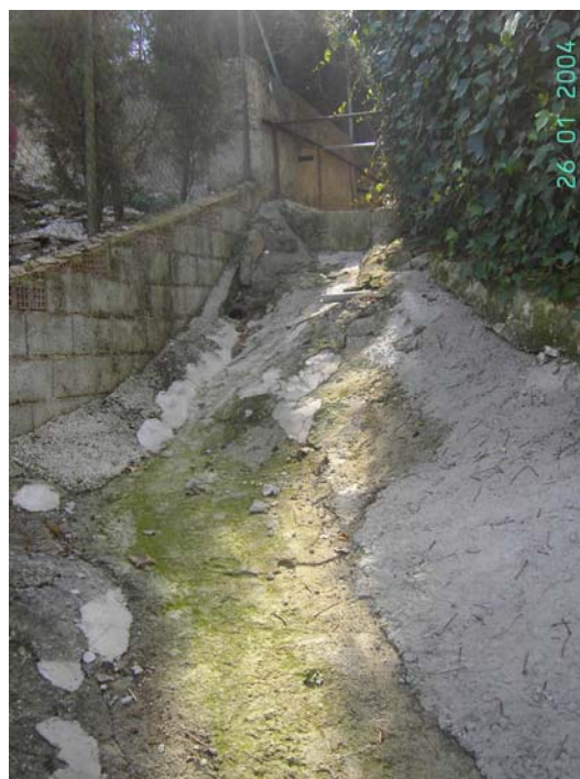
Ilustración 3. Vista de la salida del tubo de 300 de HM.
