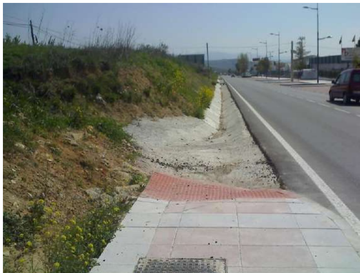
Ilustración 13. Desembocadura del Arroyo Larija a la cuneta de la JA-3305, denominada calle Príncipe Felipe
