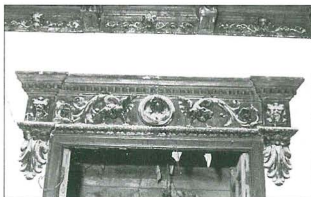
Dintel en escayola que cubre los huecos de puertas y ventanas del repartidor en planta baja
