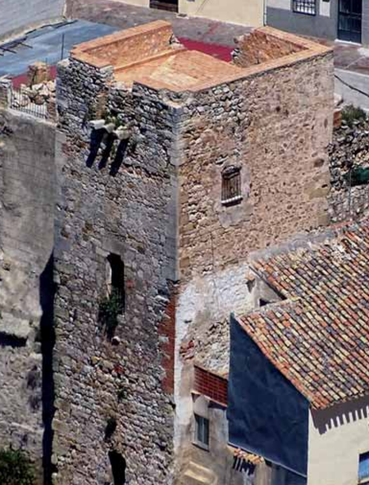
7 - Vista de la torre Almedina, en la que se aprecian los restos de viviendas adosadas a ella
