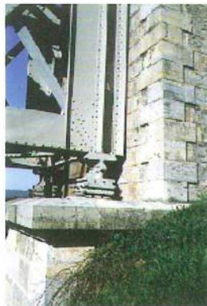
Apoyos de rodillos y rótula en el viaducto de La Sierrezuela
