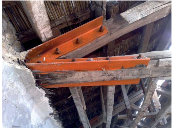
Se puede observar los refuerzos metálicos realizados en algunas de las cerchas existentes, posiblemente como consecuencia de la pérdida de apoyo por pudrición de la madera.
