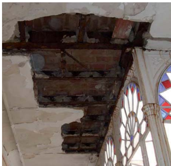
Estado en que se encontraba el techo de la galería superior; nótese las vigas de acero totalmente oxidadas con pérdida de su masa y las marcas de óxido en la estructura metálica.
