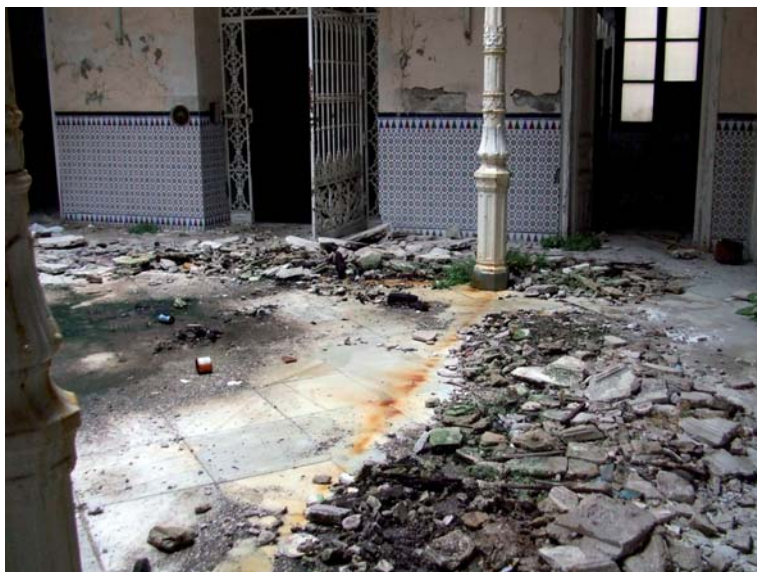
Estado en que se encontraba el patio central, al fondo y en el centro la cancela del zaguán, en el suelo restos de la edificación que fueron derrumbándose.
