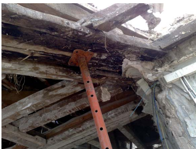
Se puede observar el apoyo en el muro de dos cerchas de la cubierta existente; nótese que la madera se encuentra totalmente podrida.
