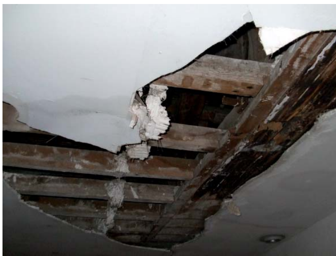
Interior de las cámaras, se puede observar el deterioro de la cubierta con abundantes filtraciones de agua de lluvia.
