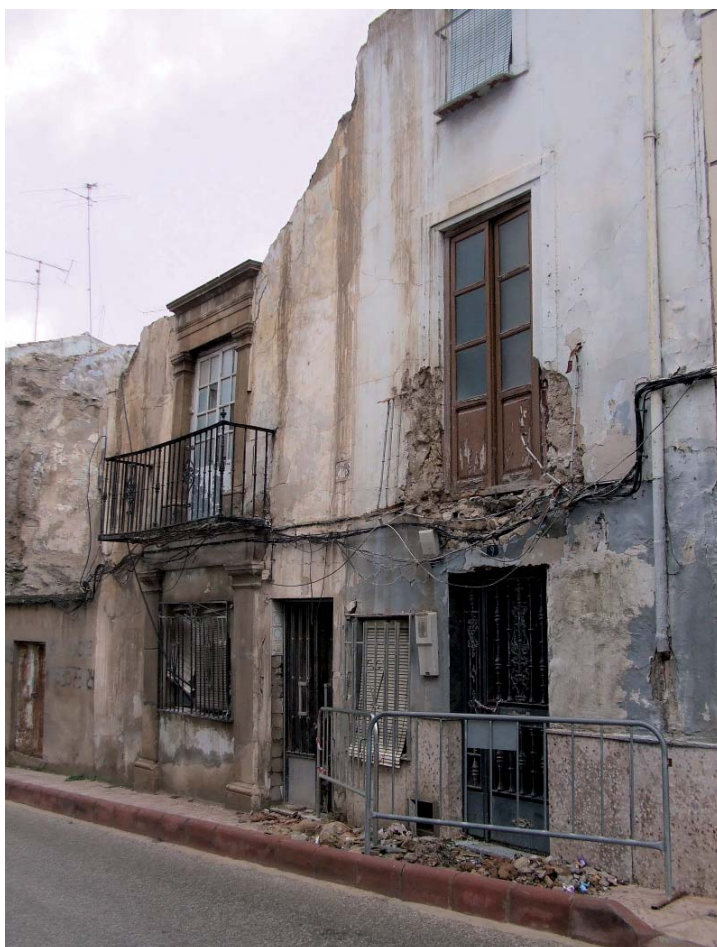
Estado que presentaba la edificación previa a las obras.
