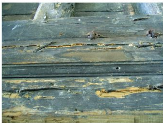
Algunas partes estaban gravemente atacadas por humedades e insectos.
