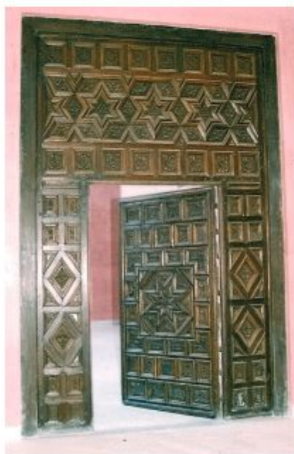
Puerta de acceso al Pabellón Real en la Cartuja tras su restauración.
