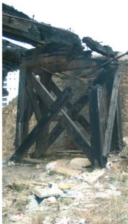
Detalle de uno de los pórticos del descargadero de Río Tinto antes de su restauración.
