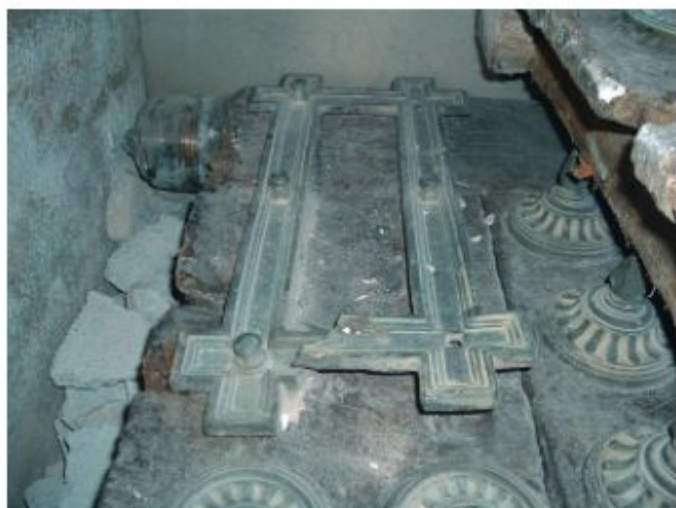
Estado en que se encontraba la parte interior de una de las hojas. Puede apreciarse la rotura del embellecedor.
