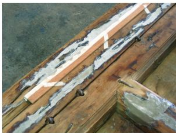
Se sellaron con material adecuado todas las galerías producidas por los insectos.
