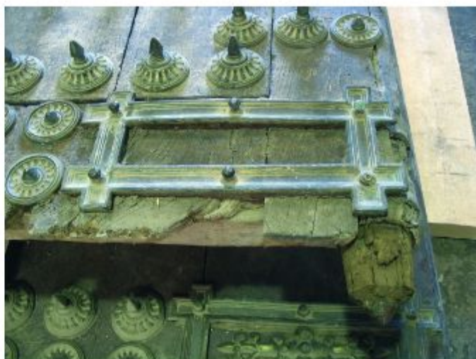
Las duelas por debajo de los postigos eran irrecuperables.
