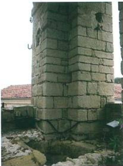
Muros del Campanario y hueco en el suelo de bajada a la torre defensiva.
