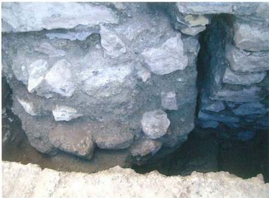
Recalce de hormigón ciclópeo realizado en los años cincuenta bajo la grieta del escudo de los Escovedo. Se observa con nitidez la abertura y el giro que alcanza la grieta a la altura del pavimento de la plaza de la Constitución.
