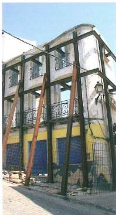
Fachada apuntalada en el Albollón.
