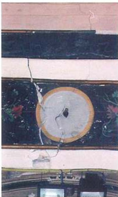
Detalle de la rotura de un arco fajón de la bóveda. Se observa el antiguo gancho de sujeción de las lámparas; el taladro servirá para introducir los tirantes de cuelgue de la bóveda.
