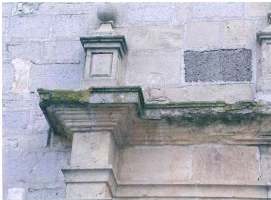
Vista del deterioro actual de molduras con pérdidas de material pétreo del entablamento de la portada que, al dejar de actuar como goterón, provoca graves deterioros en la superficie de piedra, por lo que en este caso la reposición de la materia de piedra perdida está justificada al resolver un problema patológico y constructivo.
