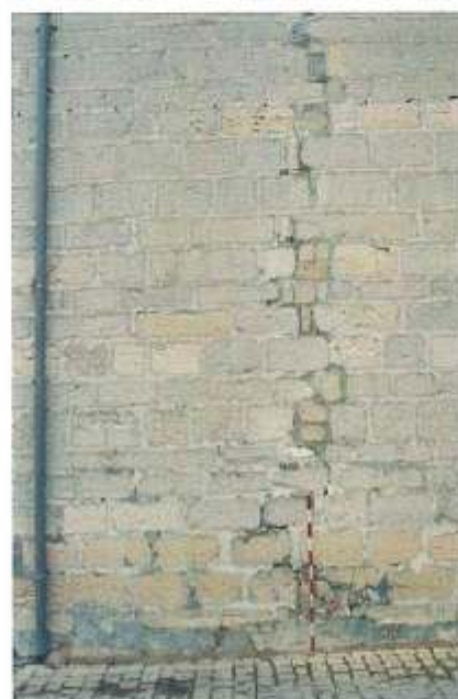
Grieta en el escudo de los Escovedo en la fachada a la plaza de la Constitución. Esta grieta es debida al apoyo del muro en un plano inclinado y al colapso del terreno a 9,00 mts de profundidad.
