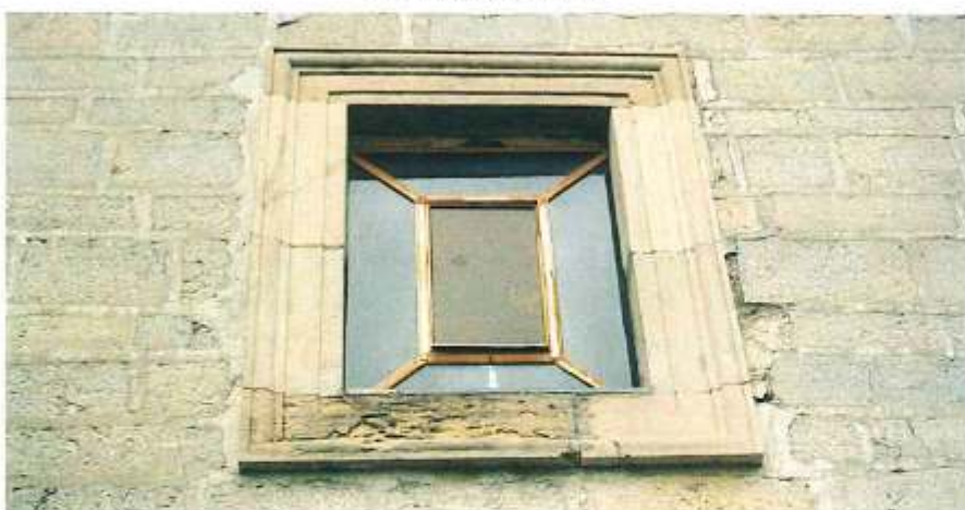
Pérdida de masa pétreo en las molduras por acanaladura del material. La carpintería de acero no es estanca, lo que produce entrada de agua al interior cuando llueve.
