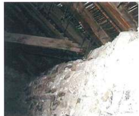
Cabeza de viga cuadrada, que sirve para atar los muros entre sí, completamente rota y desencajada. El movimiento de los muros y la falta de arriostramiento provoca el mal funcionamiento de la estructura de madera, que acaba transmitiendo empujes horizontales a los muros, produciendo una de las grietas que se observan en la fachada.
