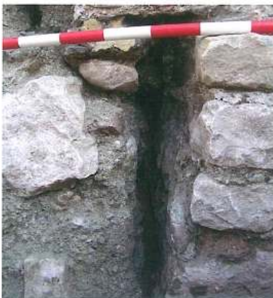
Grieta de la fachada a la plaza de la Constitución bajo el pavimento de adoquines. Se observa que tiene lugar un giro y un desplazamiento que alcanza los 12 cms. en la línea de rasante del pavimento. Si la grieta no hubiera sido cegada y resanada a la altura de la cornisa, la abertura alcanzaría los 25 o 30 cms., distancia que es la que se han desplazado los muros en su parte más alta.
