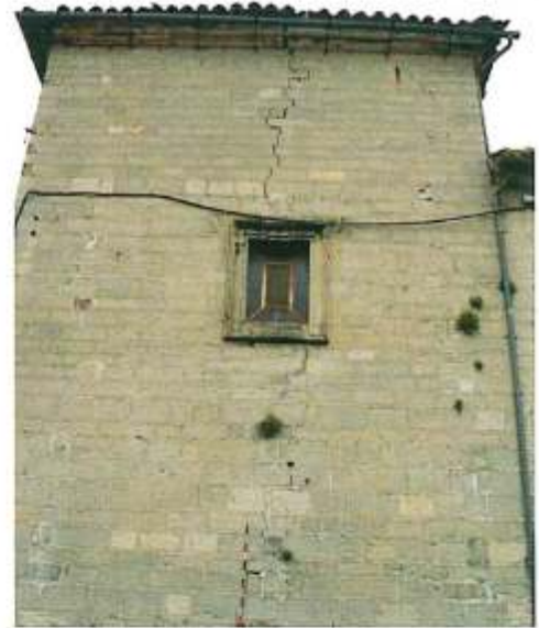
La grieta del presbiterio, abierta por arriba y cerrada por abajo, con trazado vertical, es debida al empuje de la estructura de madera de la cubierta.
