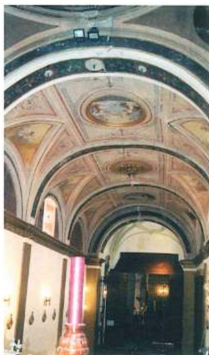
Vista actual de la capilla. La bóveda de escayola tiene abundantes grietas helicoidales, como consecuencia de los movimientos de los muros, y un importante deterioro de las pinturas, debido a las humedades de infiltración. Se observan las pilastras con cajeados eliminados y las pinturas de molduras con purpurina.
