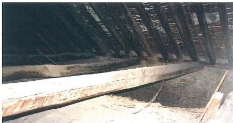
Cubierta sobre la nave principal con las armaduras de madera de par y nudillo. Se observa el fuerte deterioro de la tabla de cañizo, lo que produce movimientos de las tejas y, por consiguiente, la entrada de agua.
