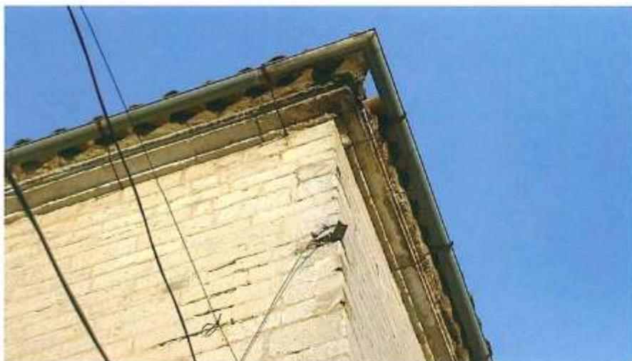
Pérdidas de material por roturas debidas a humedades, colocación de elementos extraños: palometas, taladros y escuadras adosados a fachada. En la cornisa aún se pueden observar restos del revoco de la fachada.
