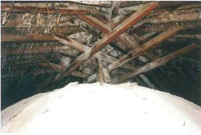
Armazón de cubierta sobre el presbiterio. El desencaje de las vigas cuadradas, los sucesivos movimientos de la capilla y las entradas de agua han producido un colapso generalizado de toda la estructura de madera. Las reparaciones que se observan, realizadas a lo largo del tiempo, no han sido efectivas, ya que no han resuelto el origen de las patologías.
