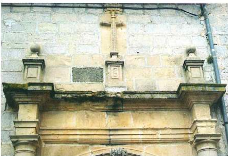
La piedra de la portada tiene diversas patologías: costra negra, disgregación, arenización, musgos y líquenes, pérdida de material y relieves en molduras. La pérdida de la moldura del entablamento produce que una de las funciones que tenía –actuar como goterón– deja de servir y, por consiguiente, se va produciendo en ese punto una mayor erosión y degradación del material pétreo.
